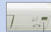
Công tắc khởi động on/off trên dàn lạnh
